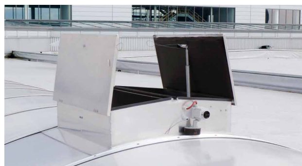
Bild 1 Taurus im Dachlichtband
