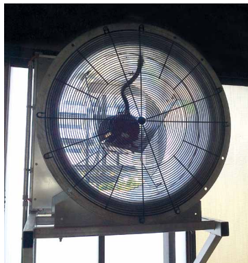
Bild 3 Maschinelle Entrauchung Lagerhalle
